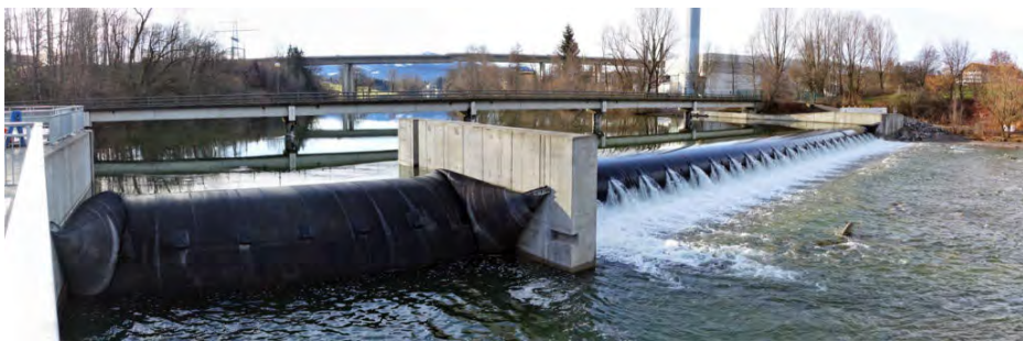
Beispielfoto: Schlauchwehr Au an der Iller bei Kempten / Allgäu [Quelle: hydroconstruct.at]
